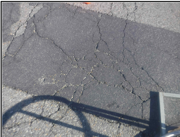
내용 도로포장 아스콘균열
