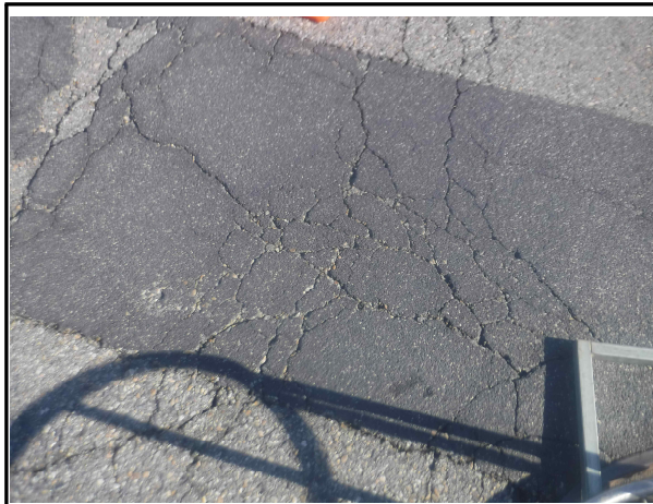
내용 신덕은문산#1 아스콘균열
