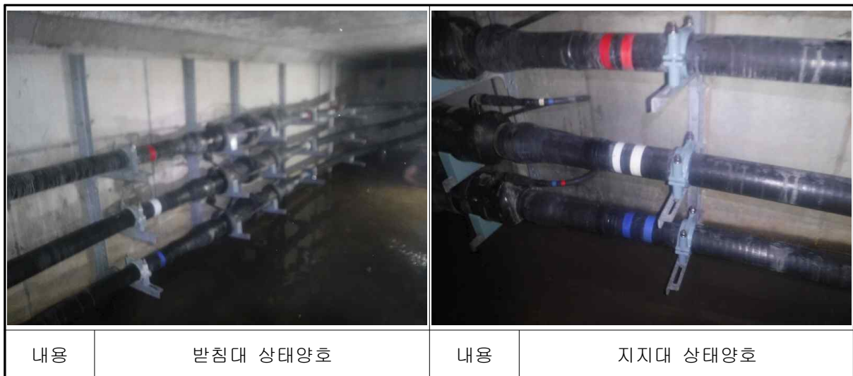
【사진 9.16】 부속 및 부대설비 현황
