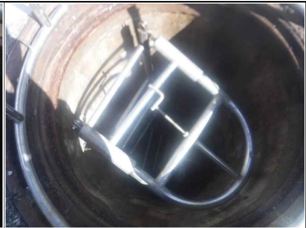
내용 추락방지시설 높이조절부파손
