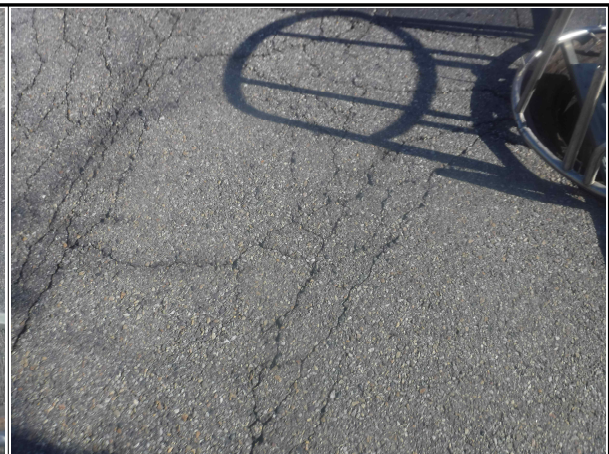
내용 도로포장 아스콘망상균열
