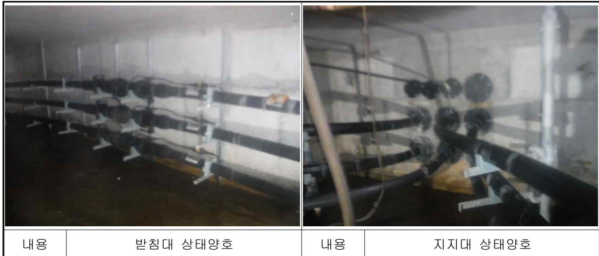
【사진 9.12】 부속 및 부대설비 현황
