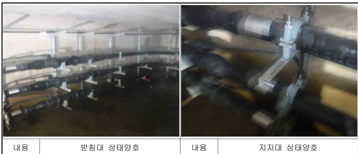
【사진 9.8】 부속 및 부대설비 현황
